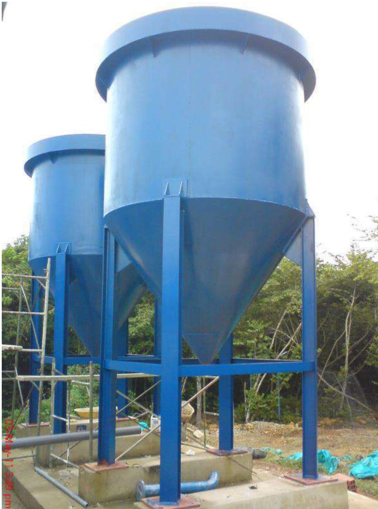
► Tanque espesador de lodos para PTAR municipal (Villanueva-Casanare)
