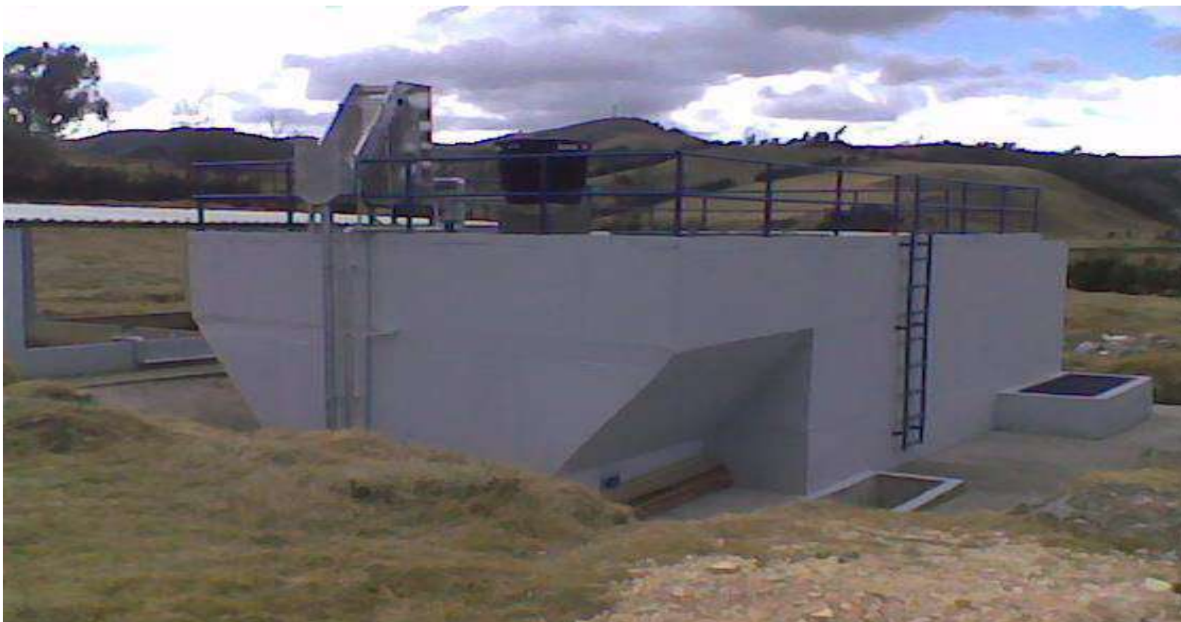
► Adecuación y re-estructuración PTAR para plantas de beneficio animal ( Chocontá-Cundinamarca )
