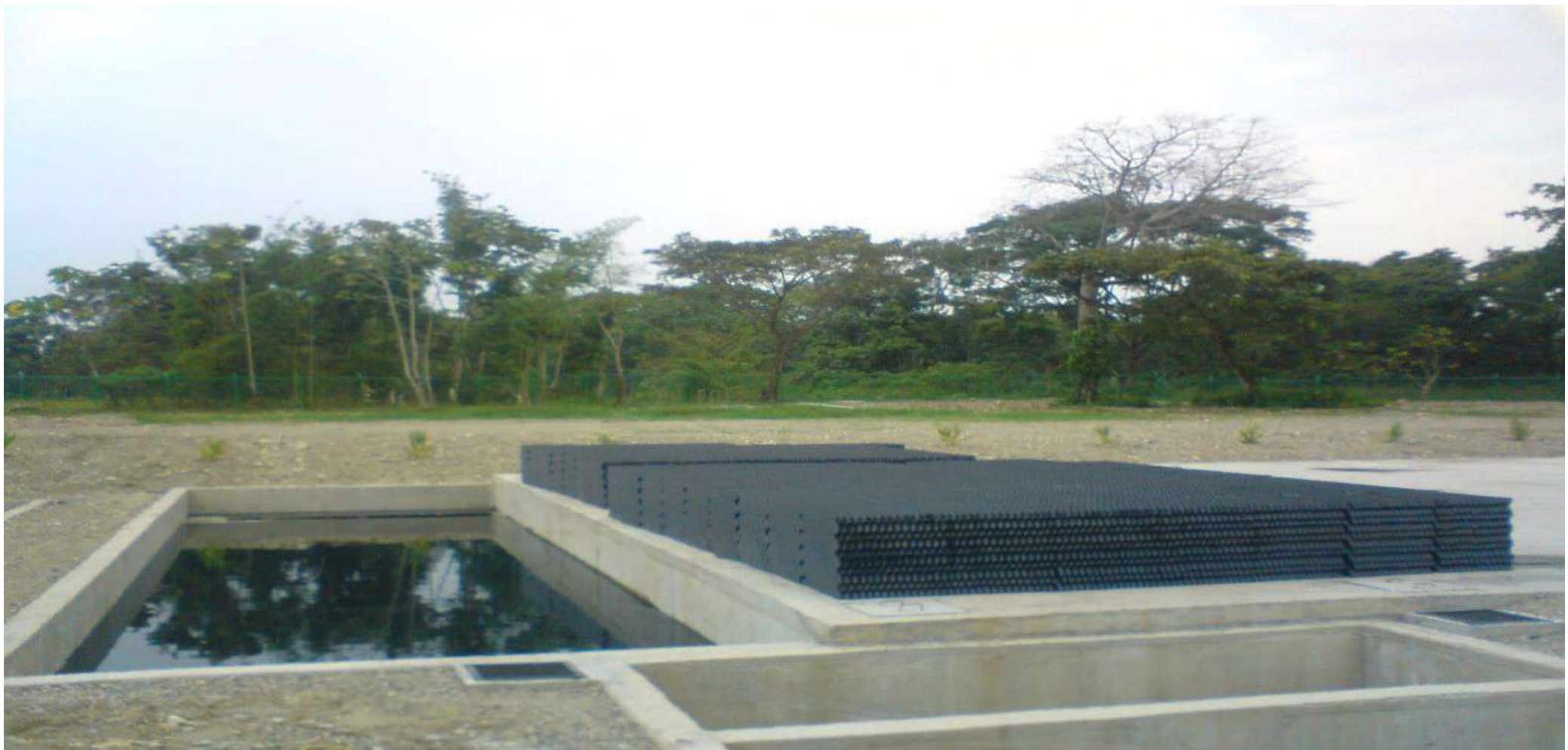
► Suministro de productos PTAR municipal. (Castilla-Meta)
